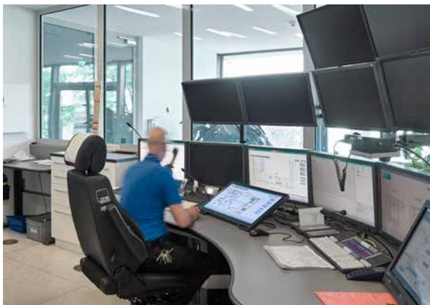
La centrale de sécurité est le « cœur technologique » de l'établissement (photo : Centre d'exécution des mesures de Uitikon). Toutes les installations techniques de sécurité et la totalité de la radiocommunication sont surveillées, commandées et enregistrées 24 heures sur 24. Photo : Peter Schulthess (2018)
