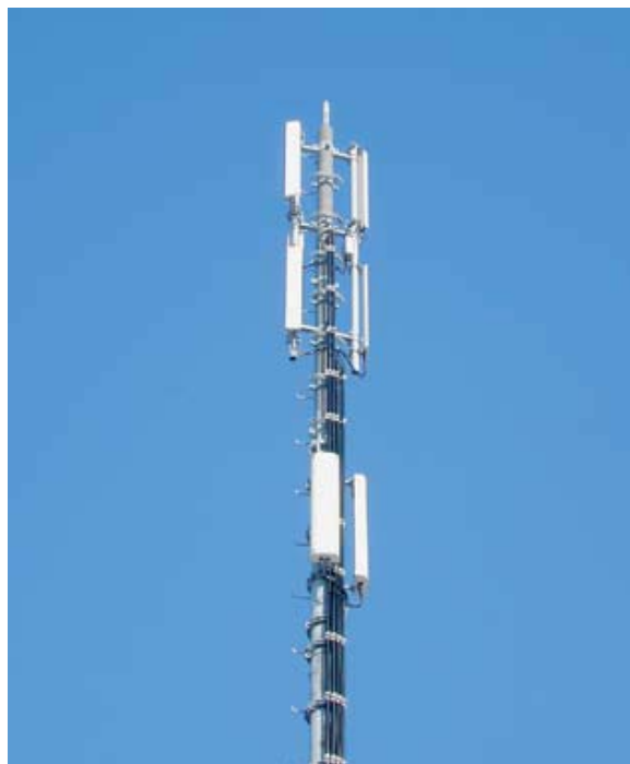
5 Station de base de téléphonie mobile.
